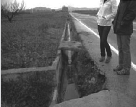
Figura 7. Captação de água da chuva em canaletas dispostas ao longo das estradas vicinais. Fonte: foto dos autores (2009)
