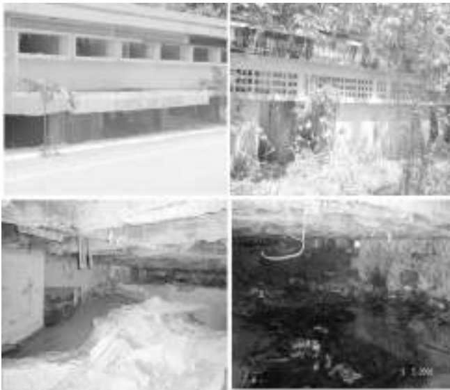
Figura 6. Hospital San Lorenzo de Armero. Fachada principal, costado e interior del primer piso. Nótese la altura alcanzada por la avalancha. Fotos tomadas por el autor.
