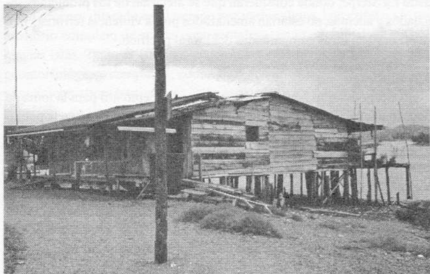
Figura 8. La inundación presentada en el año 1998 produjo la elevación del nivel de las aguas por encima de la ventana de esta casa. Fuente: trabajo de campo.
